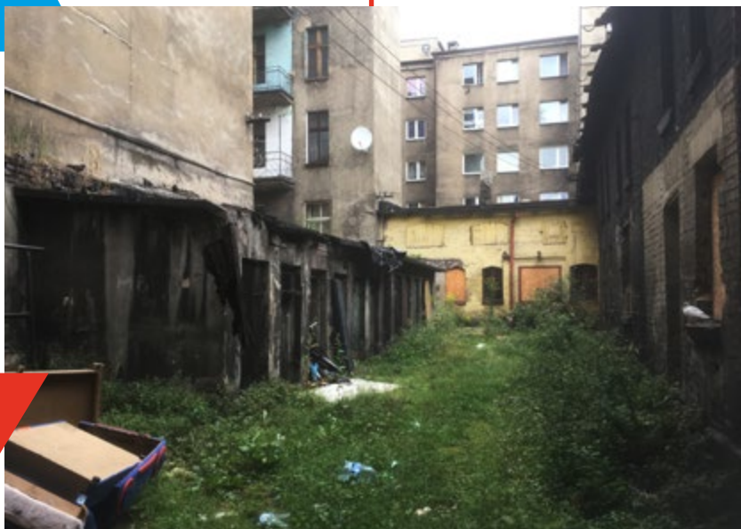
Zdewastowane podwórko należące do kamienicy przy ul. Piłsudskiego 59. Źródło: fotografia własna – Centrum Doradztwa Strategicznego
